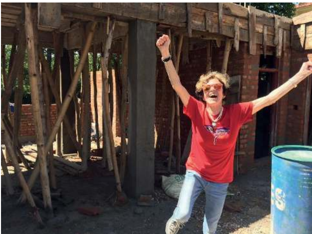
Frühjahr 2018 – die Anfänge sind gemacht Der «Teufel liegt im Detail» und wir brauchen bis Herbst 2019, bis das Gebäude bezugsfertig ist
