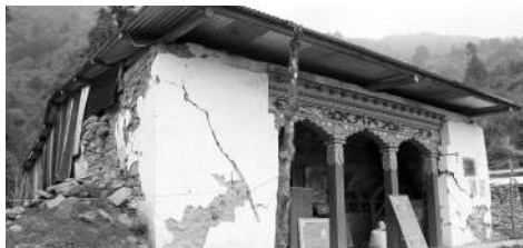
Steinhäuser, auch der Tempel, sind zerstört.
